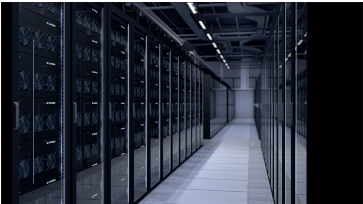
Bild 7 - Türen werden geschlossen und die weiteren Serverschränke mit jede Menge Servern versehen.
